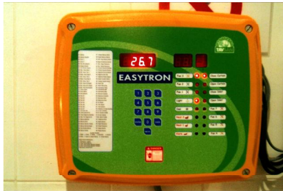
Şək.3. Havalandırma sisteminin özündə məlumat əks etdirən idarəetmə pultu.
